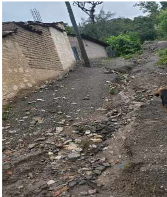
Imagen 36: Calles en mal estado
